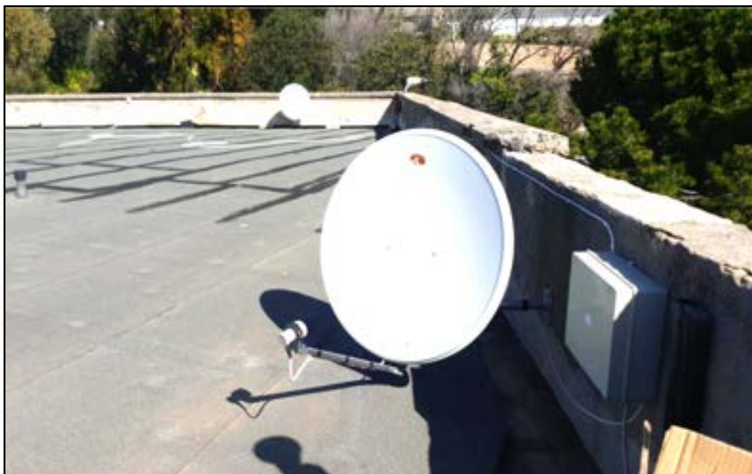
Foto dell'installazione SRS al Forte dell'Annunziata a Ventimiglia Photo de l'installation SRS au Fort Annunziata à Vintimille
