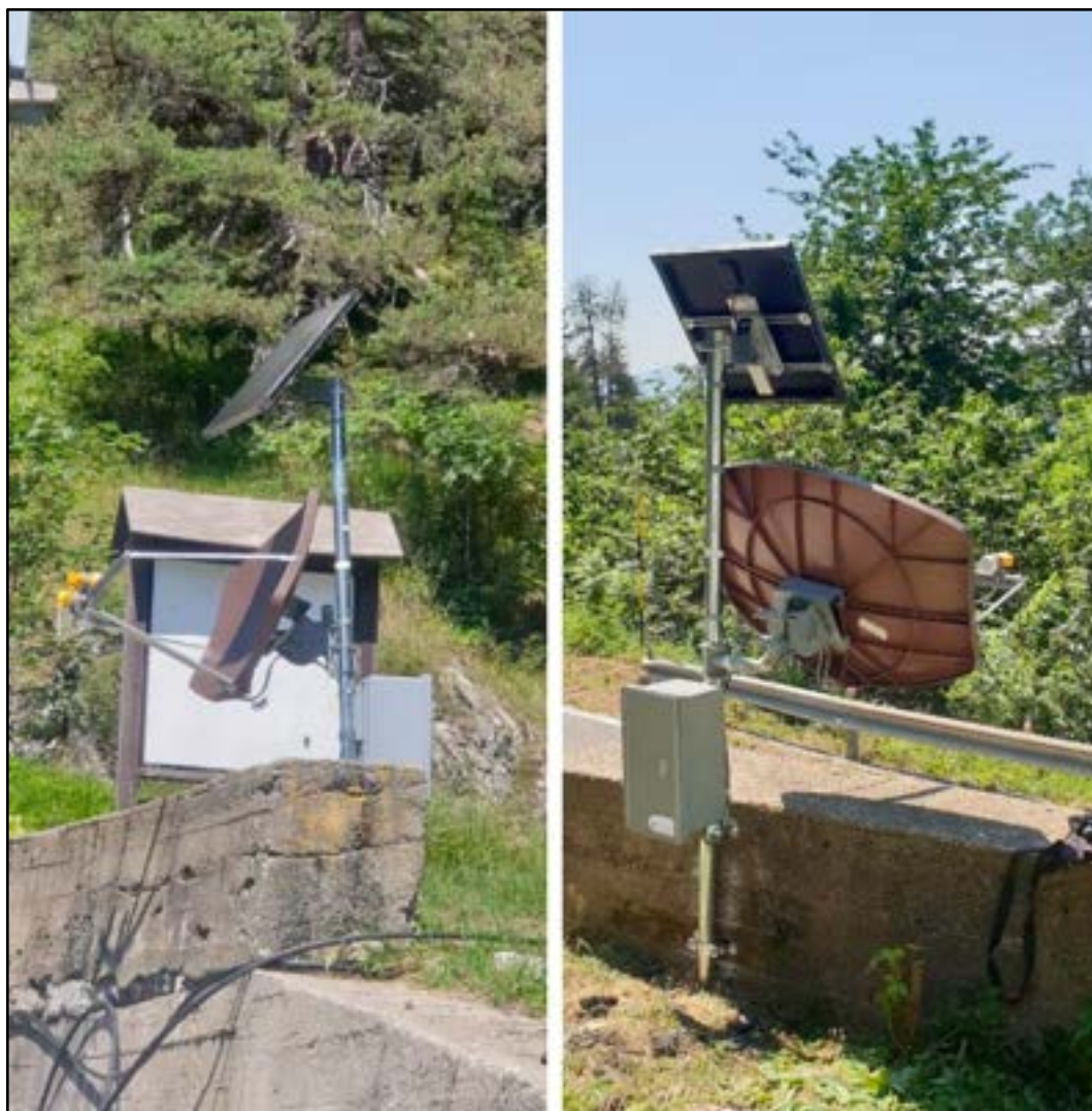
Foto dell'installazione SRS di Cosio D'Arroscia Photo de l'installation SRS à Cosio D'Arroscia
