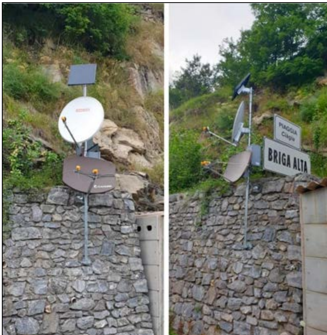
Foto dell'installazione SRS di Briga Alta Photo de l'installation SRS à Briga Alta
