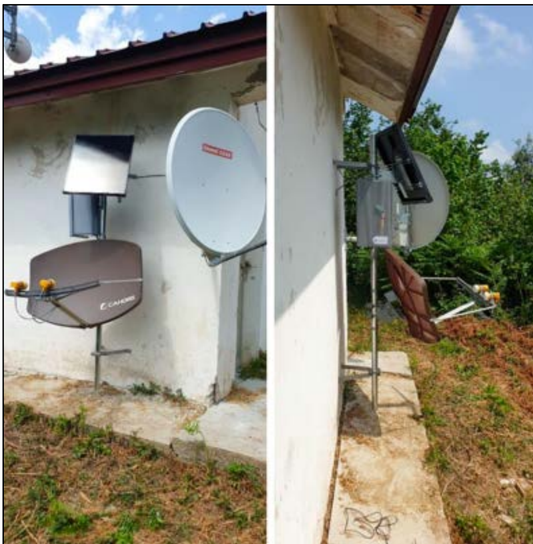
Foto dell'installazione SRS di Monesi Photo de l'installation SRS à Monesi
